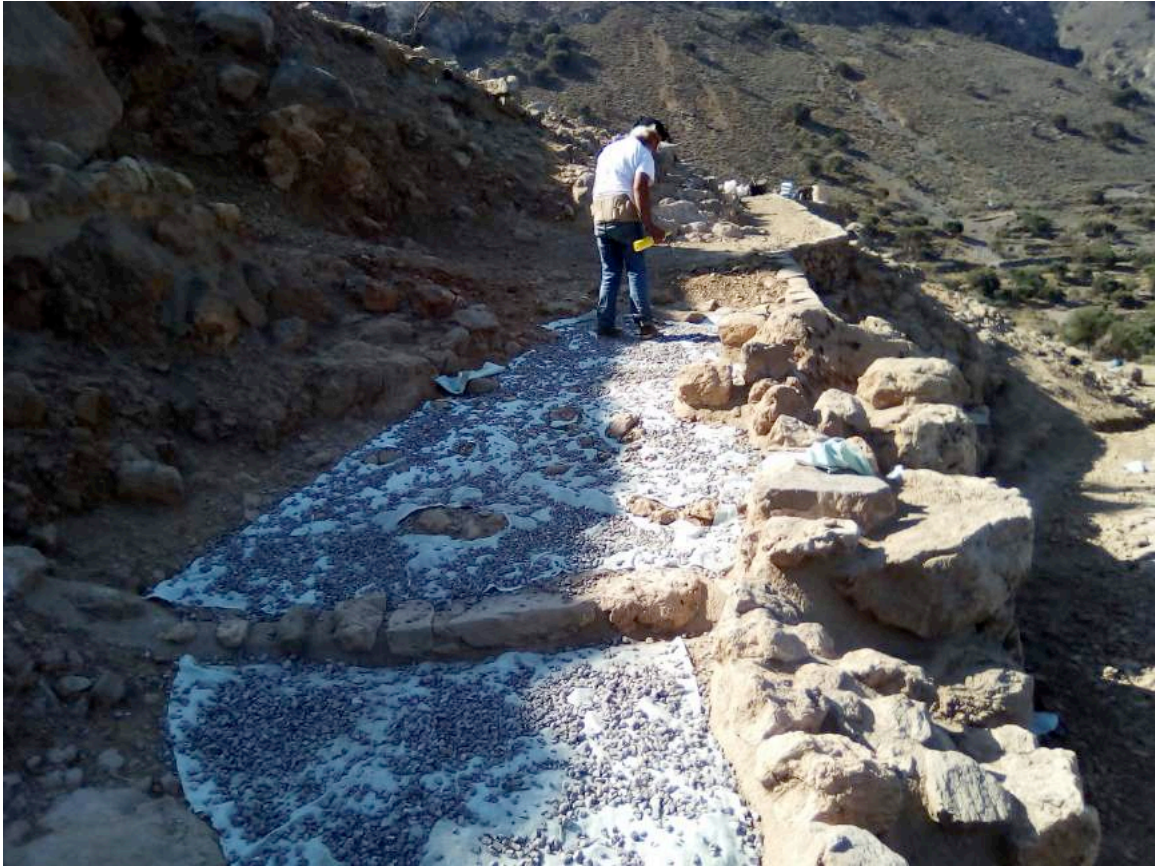
Εικ. 15. Επίστωση δαπέδου στην ράμπα D2100
